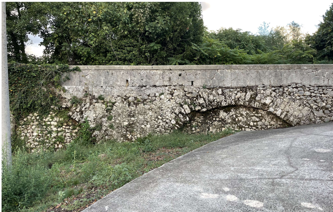
Ponte Latrano, lato a valle. Il paramento esterno in blocchi squadrati è mancante
